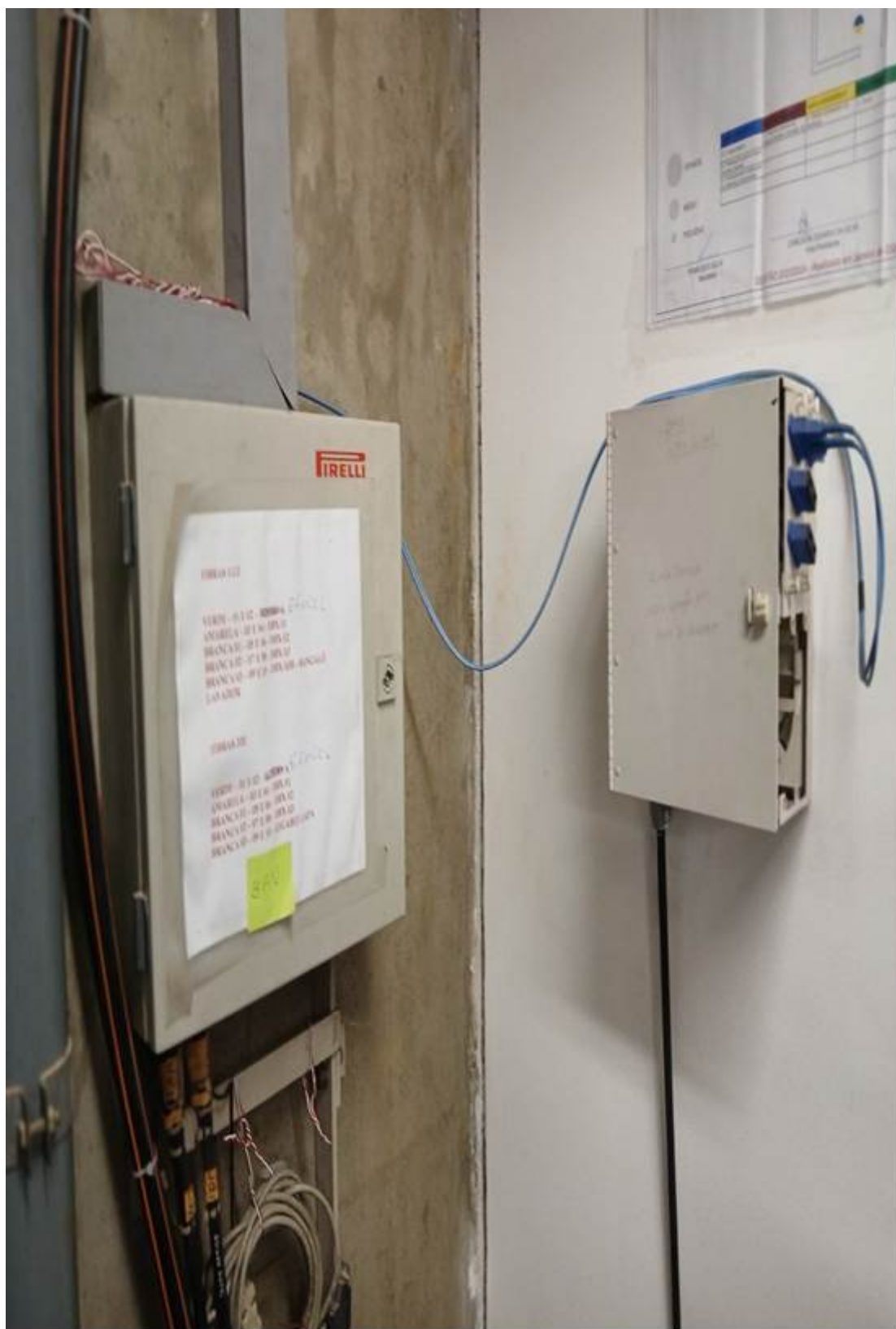
CAIXA DE PASSAGEM E FIBRA STO NEC / EFACEC – DIO FIBRAS GF1 – INFORMATICA.
