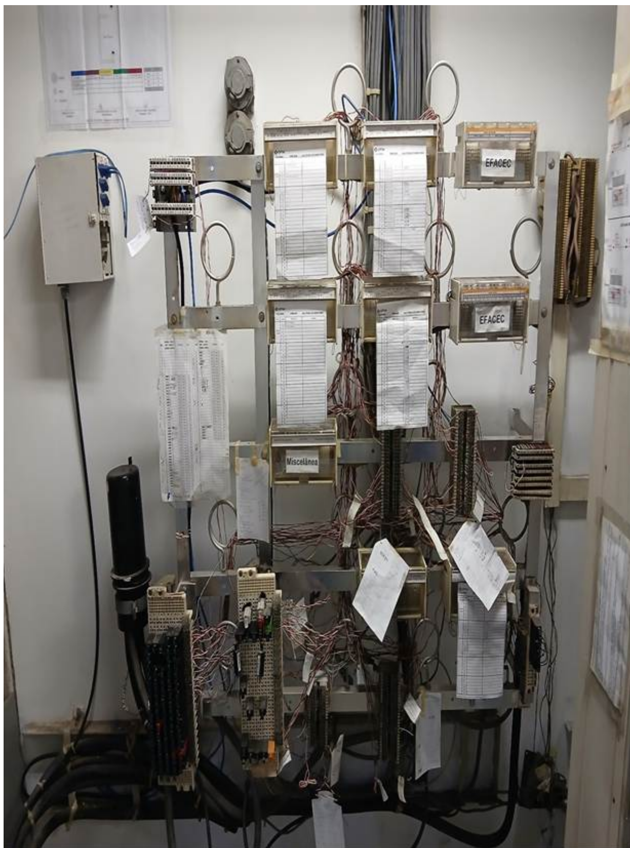
DG NEC – EFACEC EXCLUSIVO DA LINHA 7 (SERVIÇOS DE TELEFONES DA OPERAÇÃO E ADMINISTRAÇÃO CPTM) RACK DO ATO DA LINHA 7 – NÃO OPERACIONAL.
