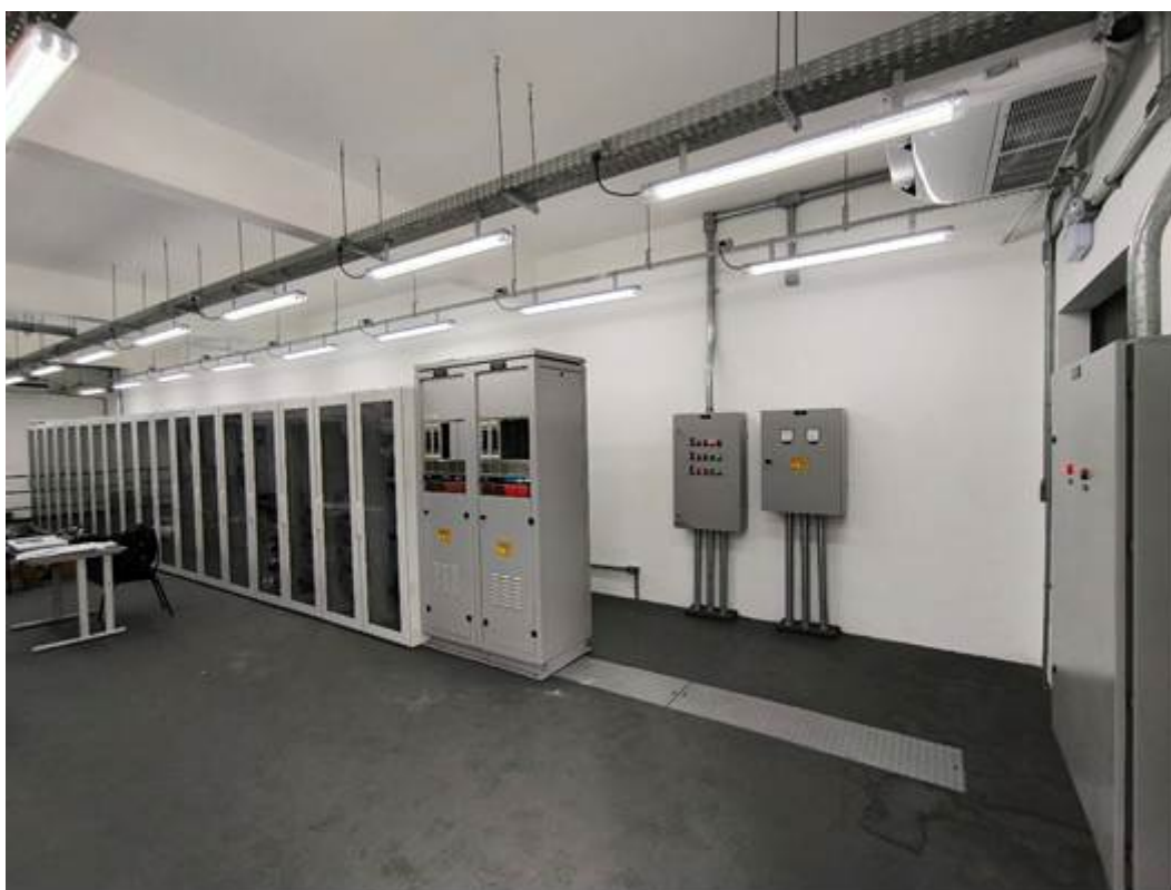
Foto 3: Equipamentos do sistema de sinalização Microlok da linha 7
