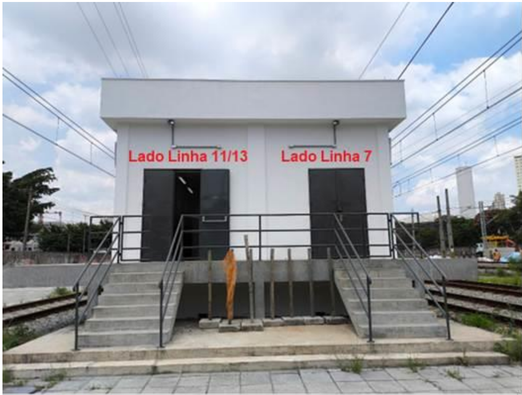
Foto 1: Entrada da sala técnica de sinalização Microlok
