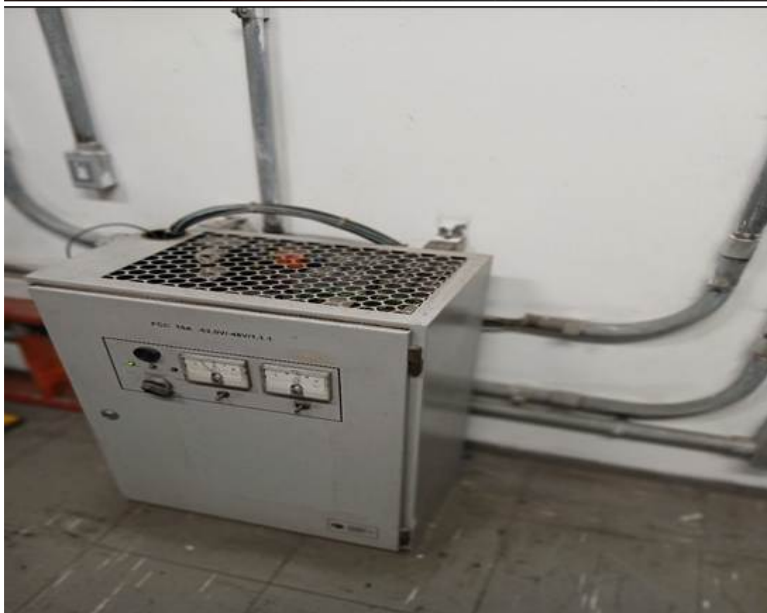
RETIFICADOR E BANCO DE BATERIAS STO NEC
