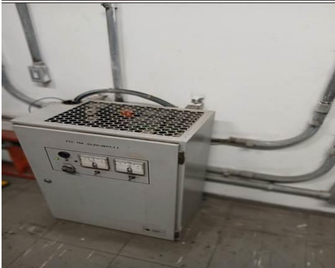
RETIFICADOR E BANCO DE BATERIAS STO NEC
