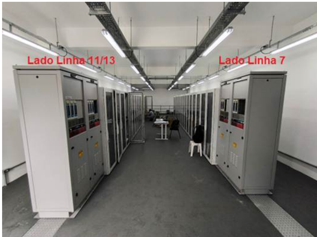
Foto 2: Disposição dos racks do sistema de sinalização Microlok L11/13 e Microlok L7
