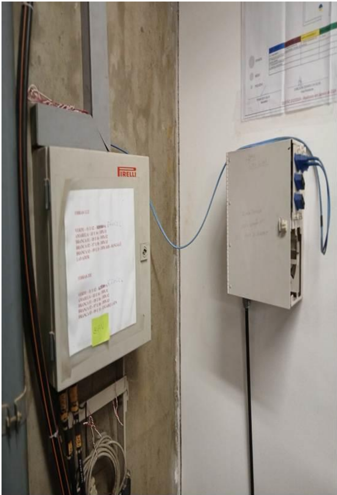
CAIXA DE PASSAGEM E FIBRA STO NEC / EFACEC – DIO FIBRAS GF1 – INFORMATICA.
