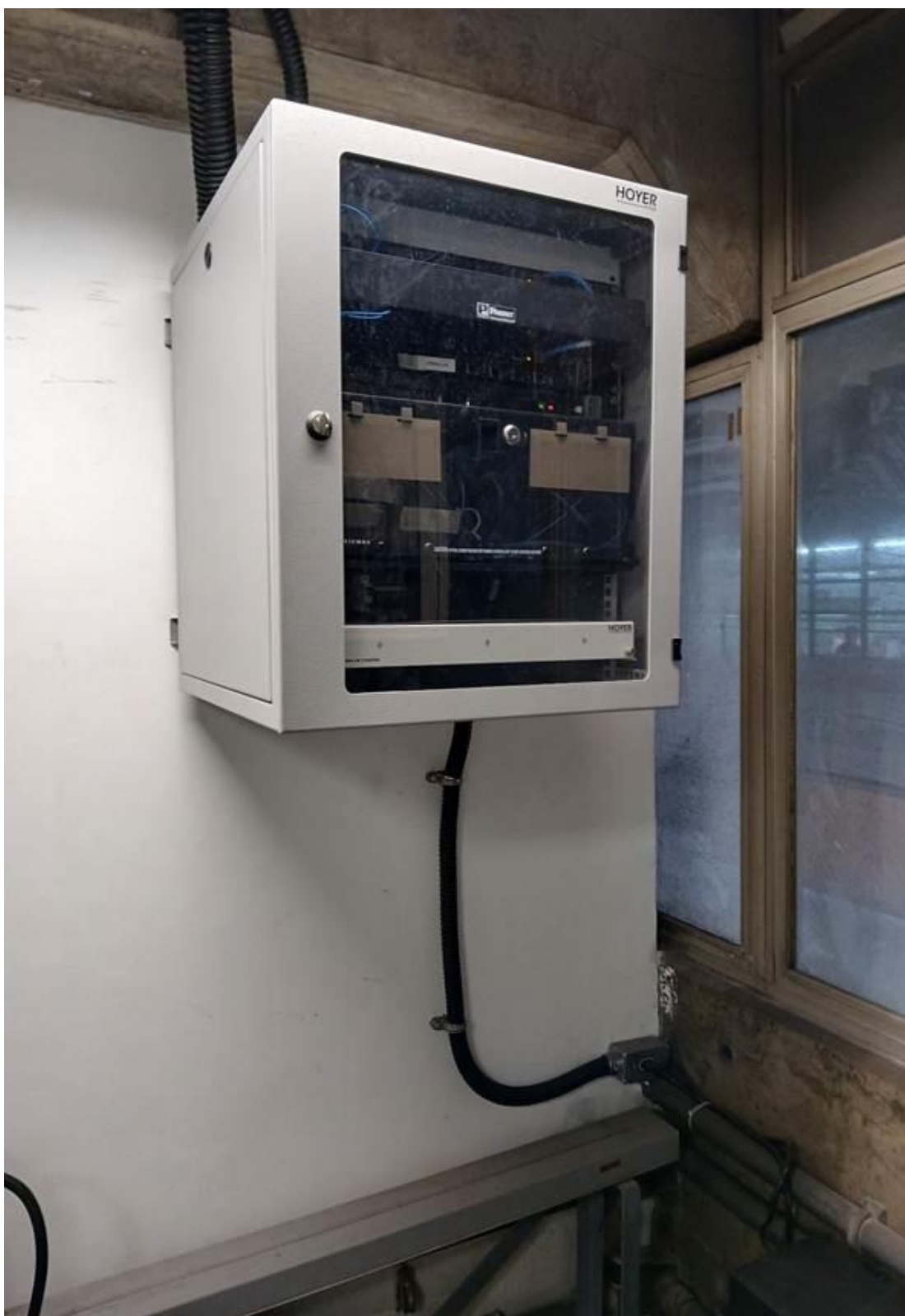
DIO DO ENCAMINHAMENTO DO SISTEMA DE SINALIZAÇÃO “MICROLOCK” – LINHA 7/11/13 E ENTERLIGAÇÃO DO SISTEMA EFACEC
