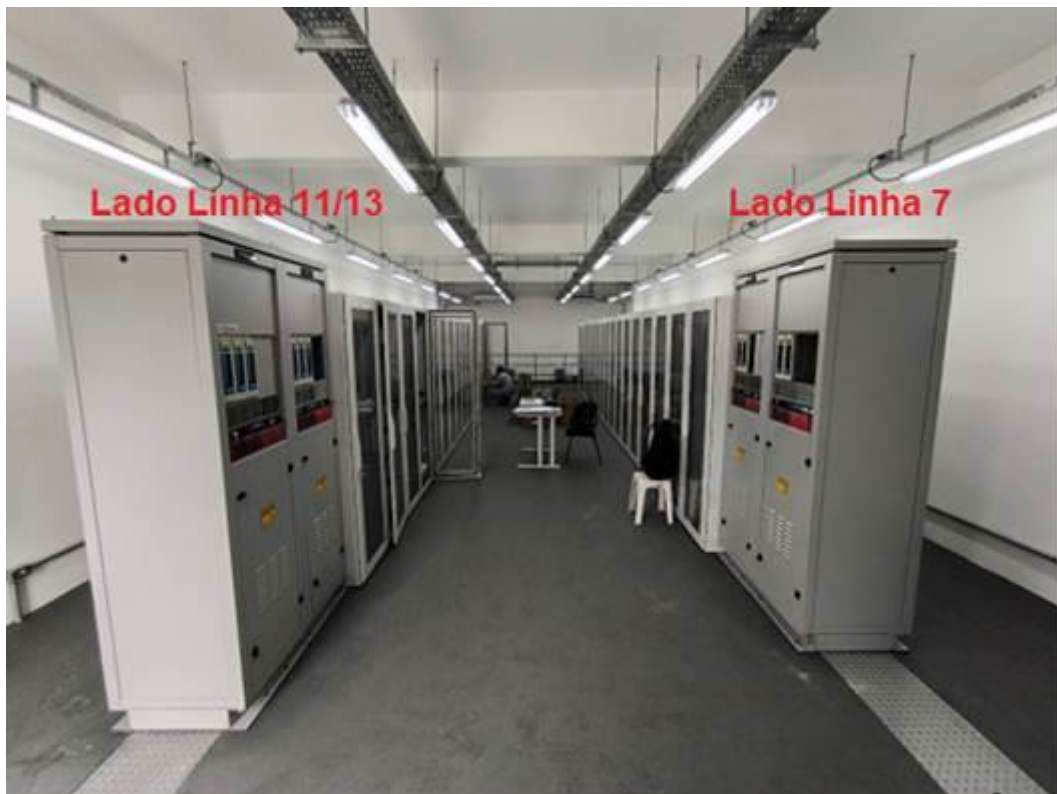
Foto 2: Disposição dos racks do sistema de sinalização Microlok L11/13 e Microlok L7
