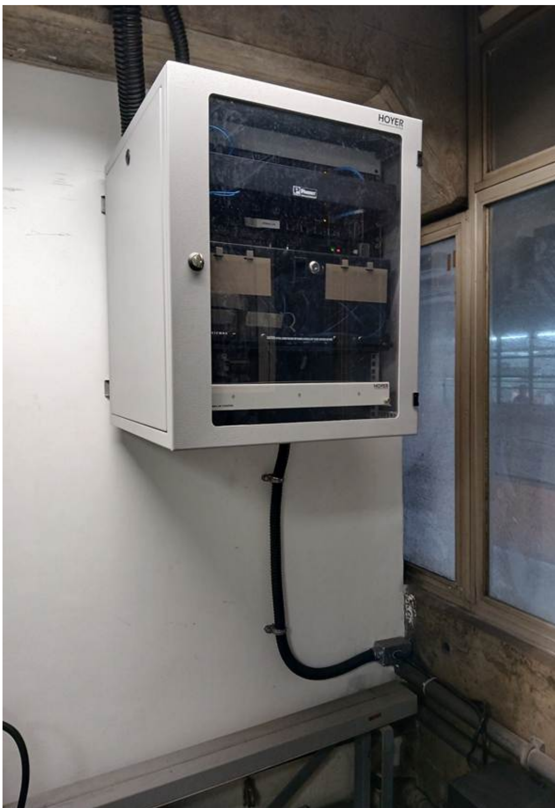
DIO DO ENCAMINHAMENTO DO SISTEMA DE SINALIZAÇÃO “MICROLOCK” – LINHA 7/11/13 E ENTERLIGAÇÃO DO SISTEMA EFACEC
