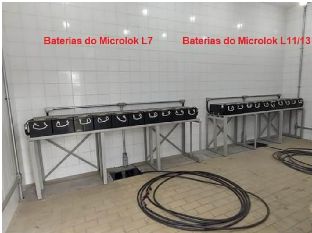
Foto 4: Sala de baterias do sistema de sinalização Microlok L11/13 e Microlok L7
