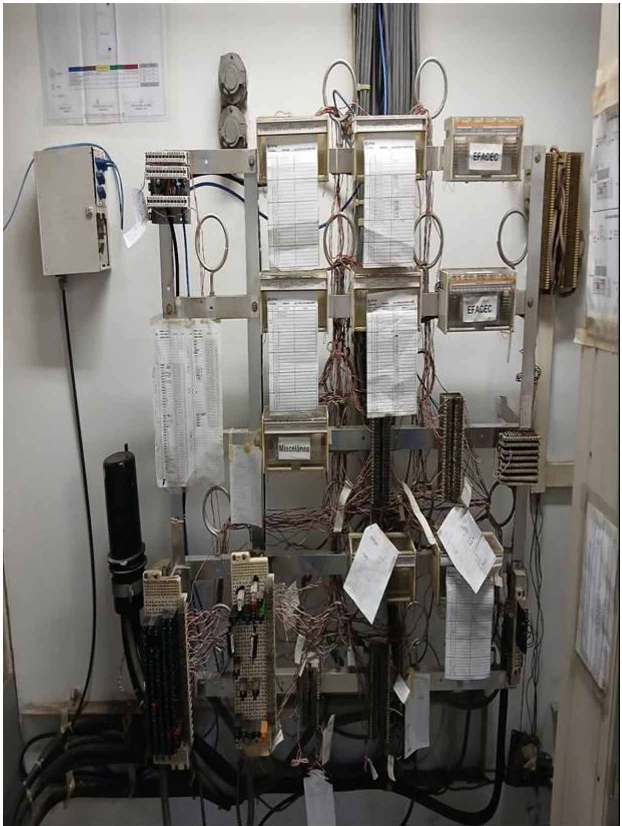
DG NEC – EFACEC EXCLUSIVO DA LINHA 7 (SERVIÇOS DE TELEFONES DA OPERAÇÃO E ADMINISTRAÇÃO CPTM) RACK DO ATO DA LINHA 7 – NÃO OPERACIONAL.
