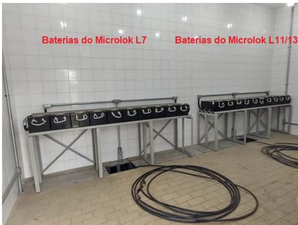
Foto 4: Sala de baterias do sistema de sinalização Microlok L11/13 e Microlok L7
