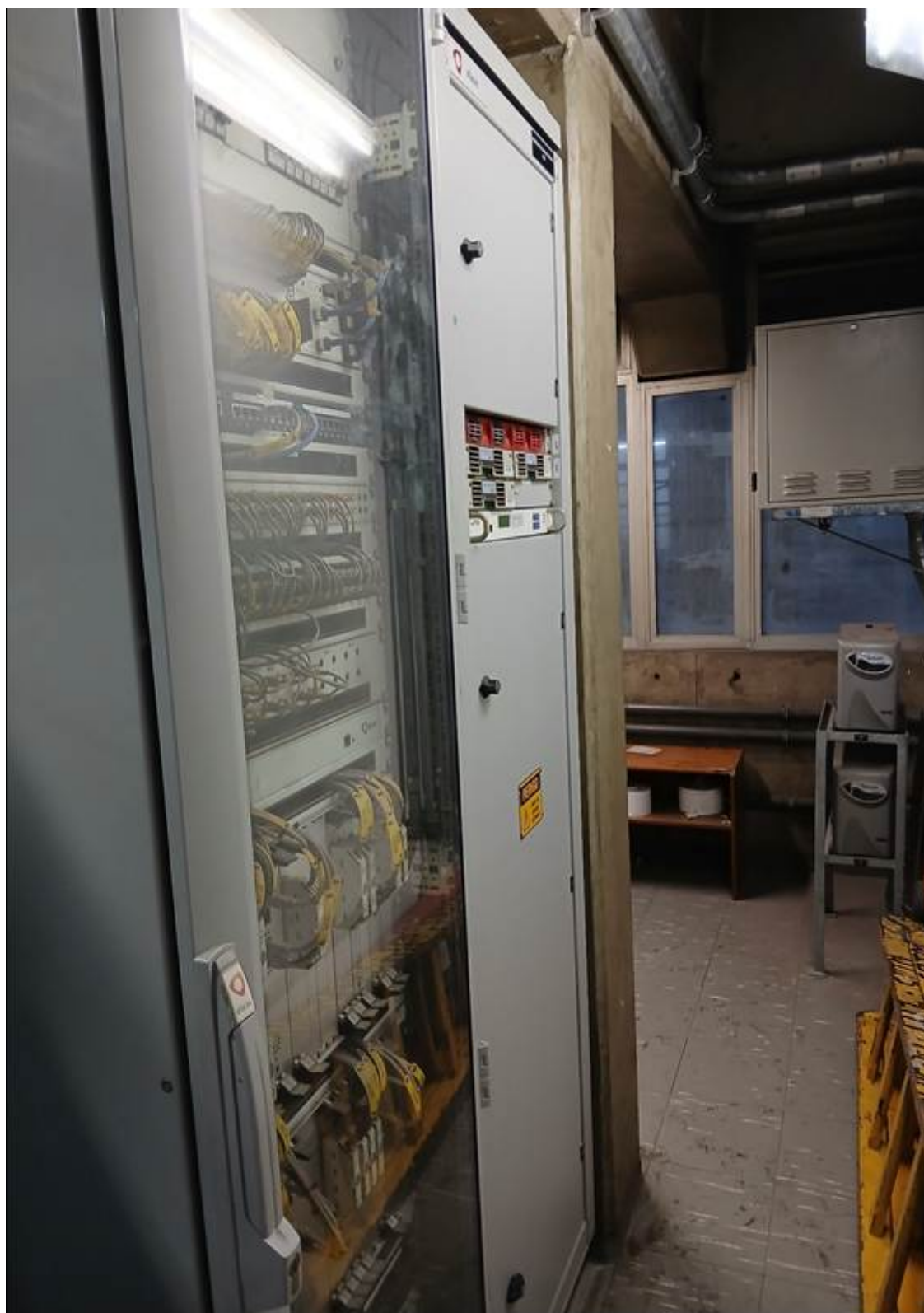
STO EFACEC – DA LINHA 7, ONDE TRAFEGA A REDUNDANCIA DO SISTEMA DE SINALIZAÇÃO DA LINHA 10 “MICROLOCK DE BARRA FUNDA”.
