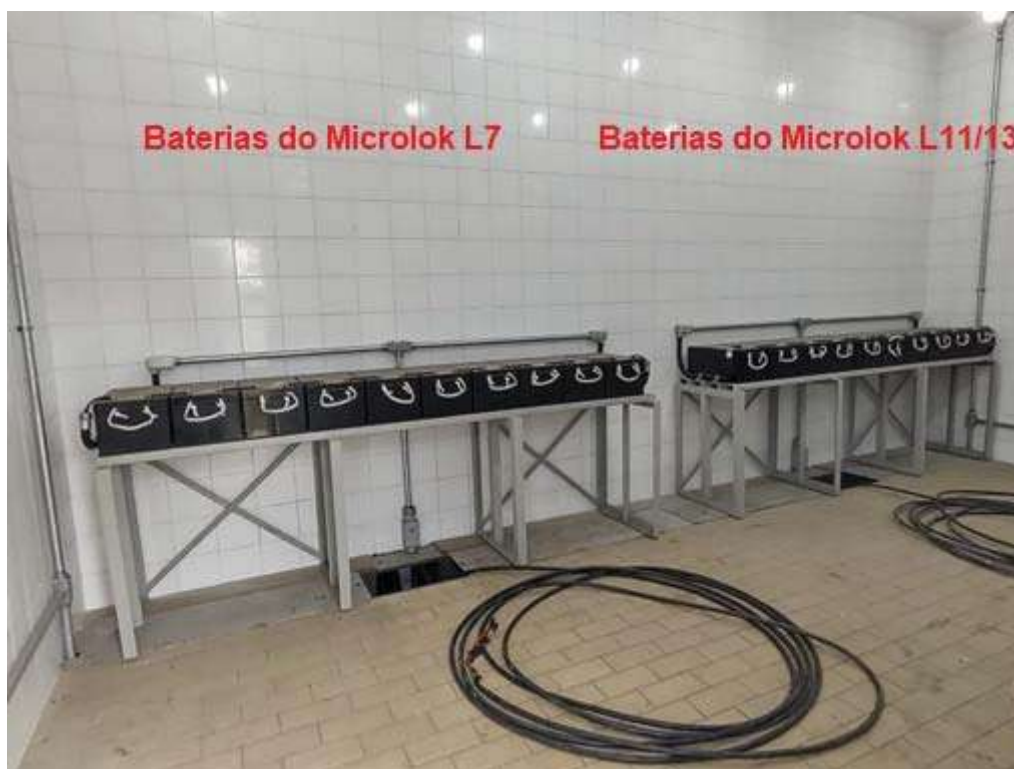
Foto 3: Sala de baterias do sistema de sinalização Microlok L11/13 e Microlok L7
